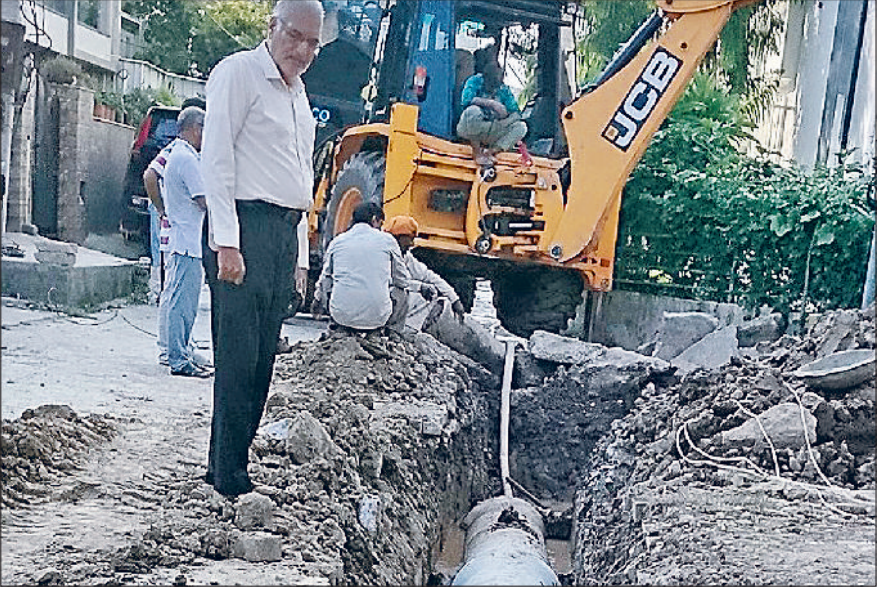
अंबाला। सेक्टर 9 में डाली जा रही पाइपलाइन में बरती जा रही लापरवाही दिखाते रिटायर्ड डिप्टी कलेक्टर वीपी दींगरा।
